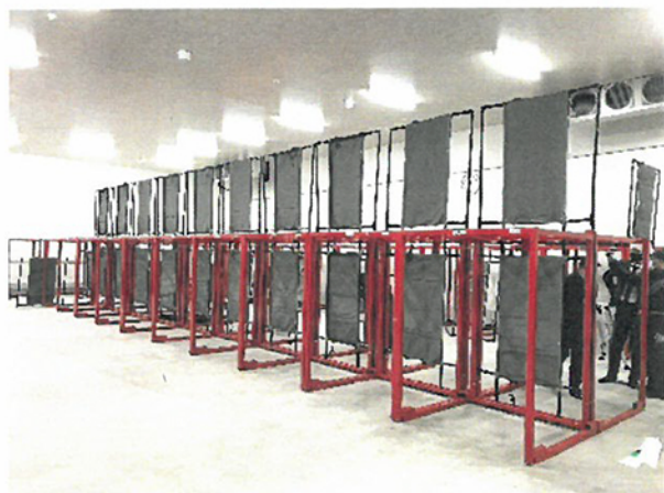
「DENBA+」を設置した冷蔵庫内
